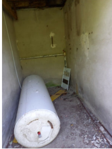
le chauffe eau
